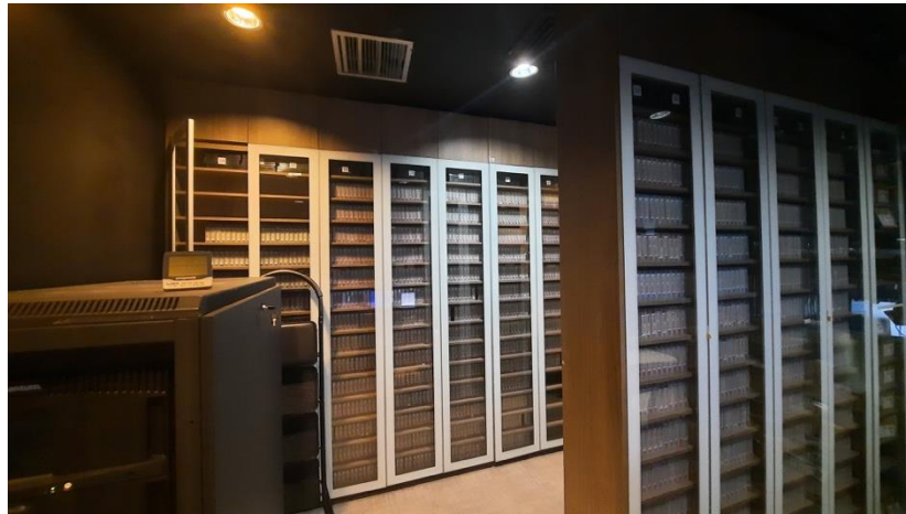
Gambar 1. Ruang penyimpanan LTO
